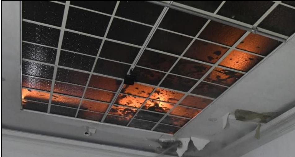
Imagem 6 Vista de uma secção de vidro do teto falso. O fogo dentro dela é claramente visível. (Foto: Luc Van Ussel)
