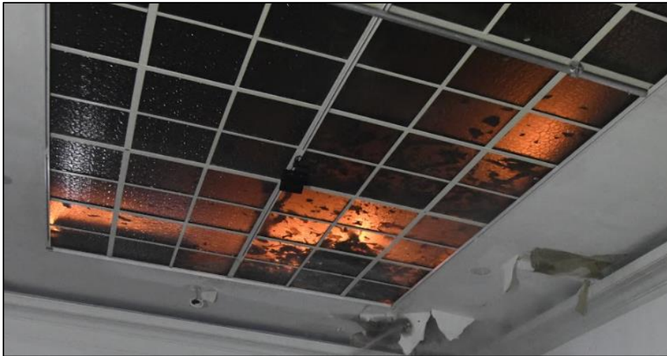
figuur 7 Zicht op een glazen gedeelte van het vals plafond. Het vuur in het vals plafond is duidelijk zichtbaar. (Foto: Luc Van Ussel)
