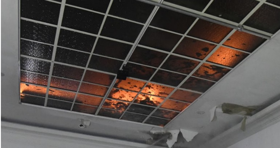
Εικόνα 7 Άποψη ενός γυάλινου τμήματος της ψευδοροφής. Η πυρκαγιά φαίνεται καθαρά στο εσωτερικό. (Εικόνα: Luc Van Ussel)
