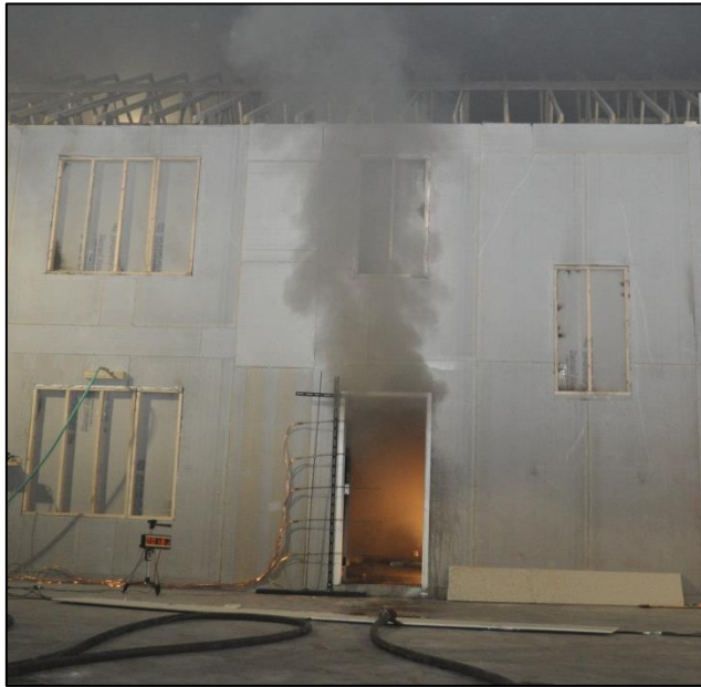
figuur 4 De rookgassen stromen uit via de bovenkant van de deuropening terwijl de rest van de deuropening gebruikt wordt voor de aanvoer van verse lucht. Deze verse lucht zal de brand snel laten groeien. (Foto: Steve Kerber - Underwriters Laboratories)
