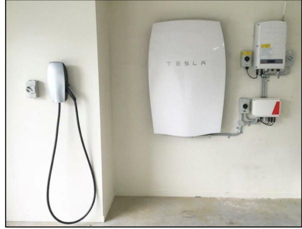
Şekil 4 Tesla piyasaya büyük miktarda elektrik depolama imkanı sağlayan çok sayıda ürün sürdü. Muhtemelen bu ürünlerin yangınlardaki davranışı elektrikli araçların bataryalarının yangınlardaki davranışları gibi problemli olacaktır. (Şekil: www.mcelectrical.com.au )
