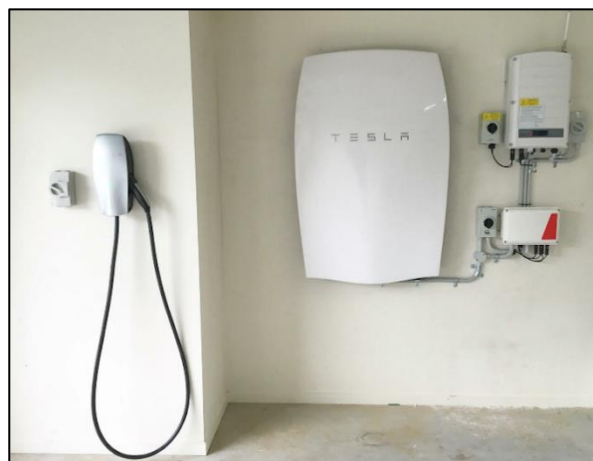
Image 4 Tesla commercialise de nombreuses applications pour stocker de grandes quantités d'électricité. Le comportement au feu de ces dispositifs sera probablement problématique au même titre que le comportement au feu des batteries de véhicules électriques. (Photo: www.mcelectrical.com.au )
