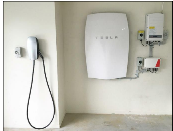
figura 4 Tesla trae un número de aplicaciones en el mercado para almacenar grandes cantidades de electricidad. El comportamiento del fuego de estos dispositivos probablemente sean problemáticos en el mismo sentido que las baterías de los vehículos eléctricos. (Picture: www.mcelectrical.com.au )
