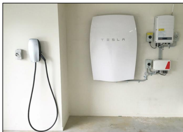
Bild 4 Das Unternehmen Tesla bringt eine Reihe von Geräten auf den Markt, die es ermöglichen, zuhause größere Mengen Elektrizität zu speichern. Es ist anzunehmen, dass das Brandverhalten dieser Apparate eine ähnliche Problematik aufweist, wie die Batterien von elektrisch betriebenen Fahrzeugen.
