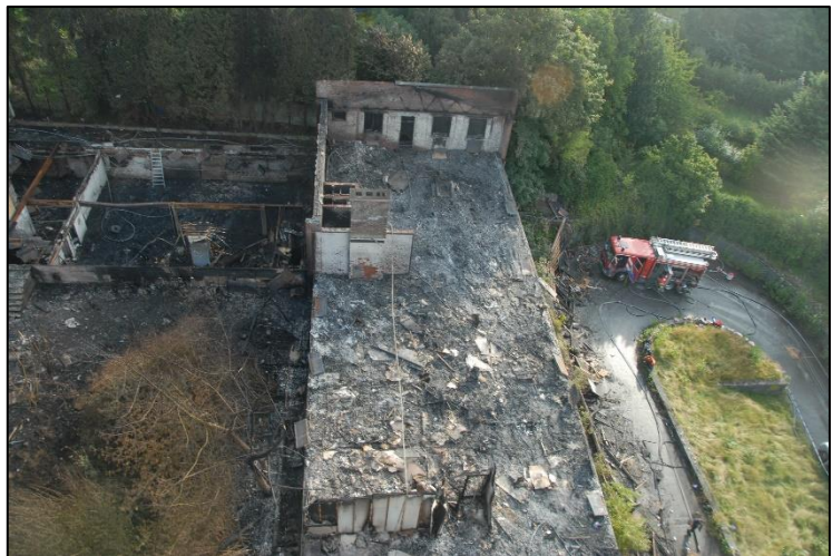
Şekil 10 Yanmış B ve C binalarının yukarıdan aşağıya görünümü. Her iki binada da betonarme kısımlar hala sağlamdır. Üst taraftaki ahşap kısım ise tamamen yanmıştır. Dikdörtgen olan duvarda çatıyı destekleyen makasların kömürleşmiş izleri görülebilir. Bu bize çatı ve asma tavan arasındaki hacim hakkında bir fikir verir. Bu resim aynı zamanda binanın arkasındaki ağaçları ve çiti de göstermektedir. Bu nedenle 360 derecelik değerlendirme olay sırasında imkansızdı (Fotoğraf: bilinmiyor)
