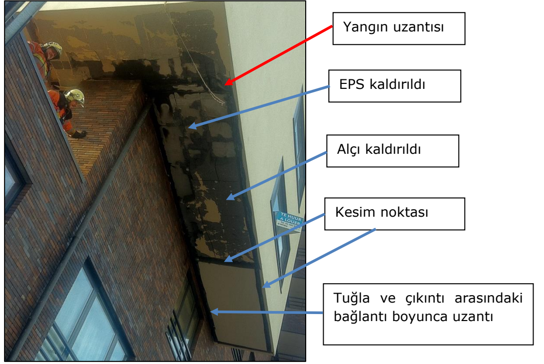
Şekil 10 Çıkıntıdaki hasar açığa çıkmış. Köşedeki siyah nokta yanmanın en yoğun olduğu yeri göstermektedir. Kırmızı ok, yangının kenarın 20-30 cm yakınına kadar yayıldığını göstermektedir. Mavi oklar itfaiye ekiplerinin yapı malzemelerini çıkardığı farklı alanları göstermektedir. (Fotoğraf: Pieter Maes)
