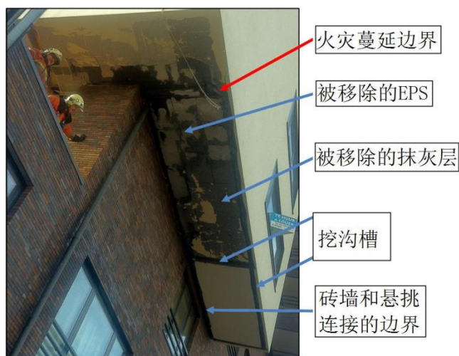
图 11 裸露悬挑部位的损伤。拐角处的黑点表示此处燃烧最猛烈。红色箭头表示火势蔓延至距边缘 20-30 厘米处。蓝色箭头表示消防员移除建筑材料的区域。照片由 Pieter Maes 提供。
