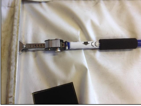
Şekil 4 Duman durdurucunun konumlandırma mekanizmasının yakın çekimi. Klipsin bastırılmasıyla çubuk ayarlanabilir. Daha sonra çubuğu ok yönünde çevirerek, cihazı yerinde tutan gerginlik eklenir (Fotoğraf: Karel Lambert)
