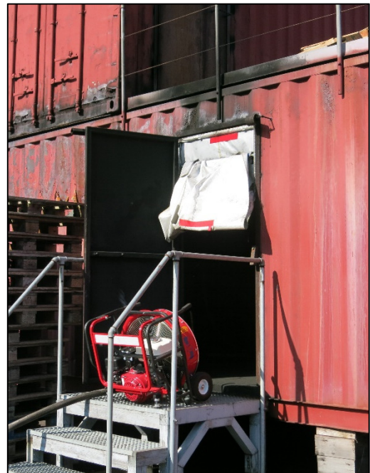
Figure 6 Le stoppeur de fumée obture la moitié supérieur de l'ouvrant limitant ainsi le phénomène de refoulement causé par le ventilateur. Le ventilateur peut être placé plus près de la porte. (Photo : Michael Reick)
