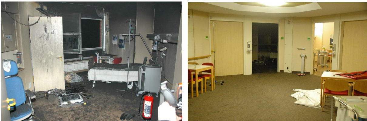
Bild 8 Ein Krankenhauszimmer in Deutschland nach einem Brand. Das linke Bild zeigt den geschwärzten Brandraum, der komplett mit Rauch gefüllt war. Die rechte Aufnahme zeigt den Flur. In der Mitte des rechten Bildes befindet sich die Türe, die zum Brandraum führt. Es sind keine Rauchschäden im Flur zu erkennen. Der Rauchstopper liegt am Boden auf der unteren rechten Seite des Bildes ( Photo: Michael Reick )
