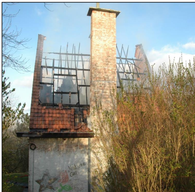
Figura 1 Os pontos de fixação do travejamento foram parcialmente queimados. Quando as condições do vento são ferozes, as empenas podem entrar em colapso. A chaminé provavelmente também está ligada às vigas, podendo aí existir danos. (Foto: desconhecida)
