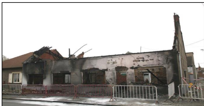
Figura 3 Após um incêndio, apenas as paredes permanecem de pé. Recorrendo barreiras separadoras e fita de sinalização, é delineada a zona de colapso. (Foto: Herman De Wit)
