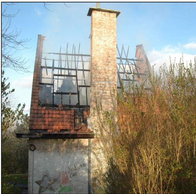
Figure 1 I punti di fissaggio delle balle sono stati parzialmente bruciati. Quando le condizioni del vento sono forti, questi timpani possono crollare. Anche il camino è probabilmente attaccato alle travi. Potrebbero esserci danni anche a questo punto. (Photo: unknown)
