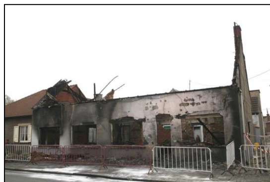
Figure 3 Dopo un incendio rimangono in piedi solo i muri. Utilizzando barriere anti-folla e nastro adesivo, viene delineata la zona di collasso. (Photo: Herman De Wit)
