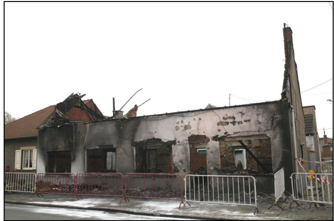
Figure 3 Après un incendie, seuls les murs encore debout. En utilisant des barrières de sécurité et du ruban de balisage la zone de chute est délimitée. (Photo: Herman De Wit)
