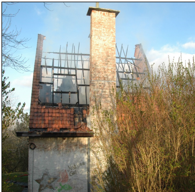
Figure 1 Les points de fixation des pignons ont été partiellement brûlés. En cas de vent violent, ces pignons peuvent s'effondrer. La cheminée est probablement attachée aux chevrons. Il peut y avoir des dommages à ce niveau également. (Photo: inconnu)
