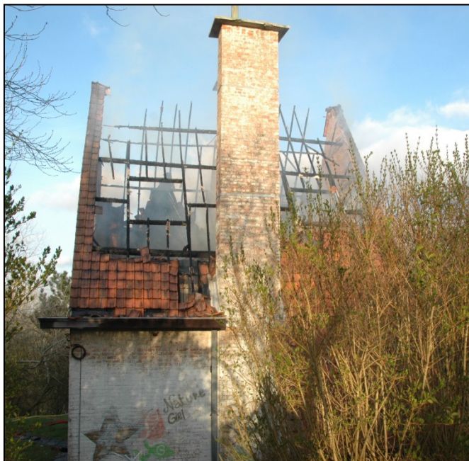
Figura 1 Los puntos de fijación de los gabletes estado ardiendo parcialmente. Cuando las condiciones de viento son fieras, estos gabletes quizás colapsen. La chimenea está probablemente fijada a las vigas del techo también. Quizás haya daño también en este punto. (Photo: unknown)
