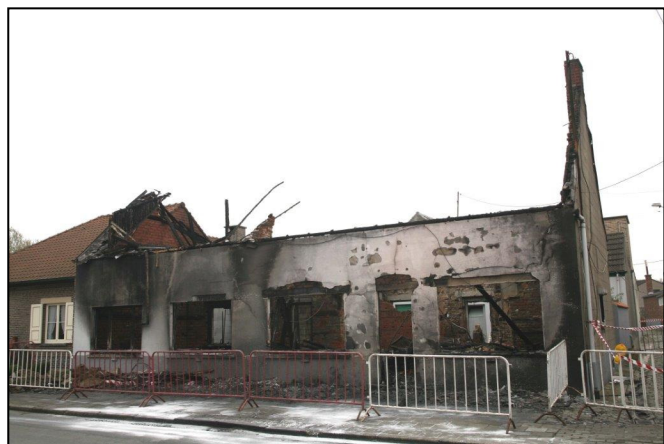
Figura 3 Después de un incendio solo las paredes quedan de pie. Usando barreras para las personas y cinta de balizamiento la zona colapso de delimita. (Photo: Herman De Wit)
