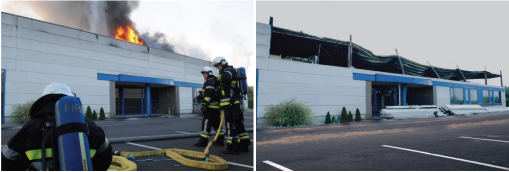
图 4 由预制墙板组成的工业建筑发生火灾。因为有倒塌风险，消防员与墙体保持一定的距离。
