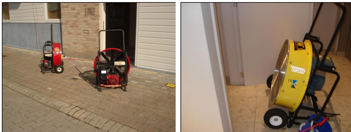
Figs. 9.12 & 9.13 Nos testes em Oostkamp, foram posicionados dois ventiladores em forma de V na porta de entrada de um bloco de apartamentos, tendo sido adicionado um terceiro ventilador no caixa de escadas. (Foto: Karel Lambert)
