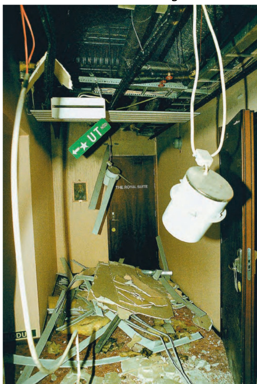
Fig. 1.4 Consecuencias de una explosión de humos. (Photo: Roland Stregfelt, www.msb.se )
