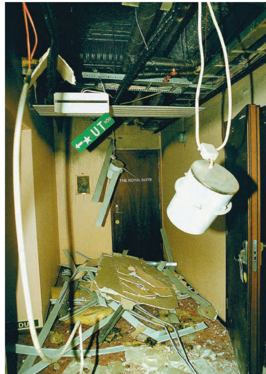
Bild 4 Die Folgen einer Smoke Explosion (Foto: Roland Stregfelt, www.msb.se )
