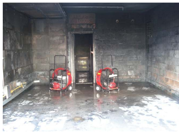
Fig 9.11 Dispositif de ventilateurs en V dans un local où les murs latéraux sont trop proches et ne permettent pas l'aspiration d'une quantité d'air suffisante (Photo: Karel Lambert).
